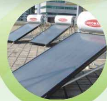
太陽能發電設備
